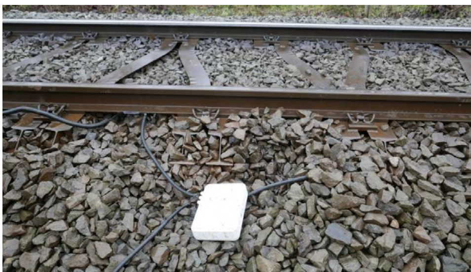
Obr. 9: Instalace snímačů a měřicí jednotky
