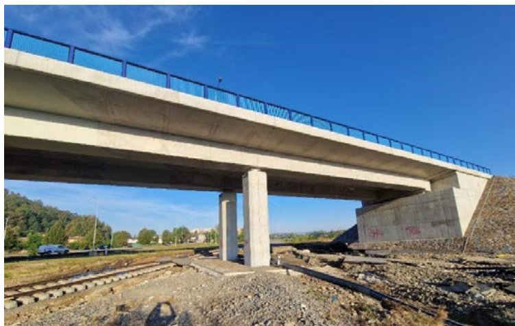
Obr. 7: Zbytky kolejíště a zcela chybějící místní komunikace pod mostem
