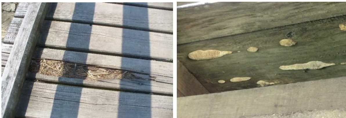
Obr. 3: Smrková prkna mostovky poškozena hnilobou (vlevo) a dubová prkna mostovky poškozena suchou hnilobou (vpravo).
