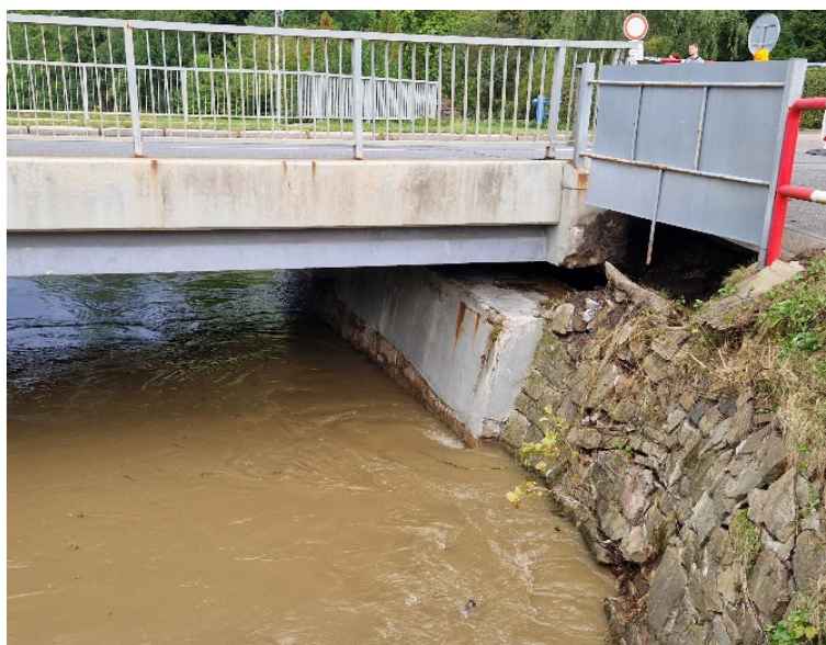
Obr. 1: Pokles opěry o cca 300 mm vlivem podemletí (Porubka, Ostrava)
