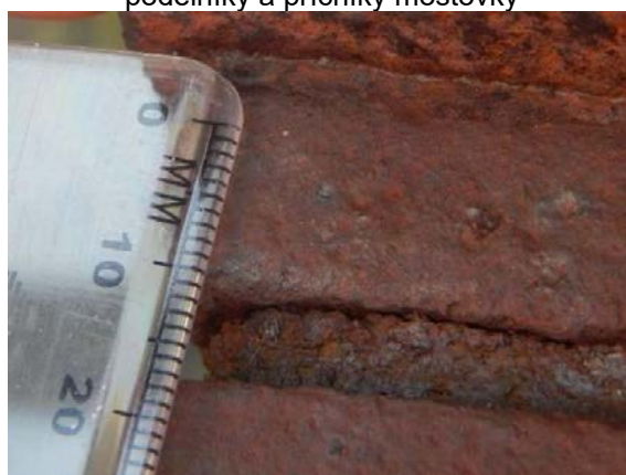
detail štěrbinové koroze šroubového spoje
