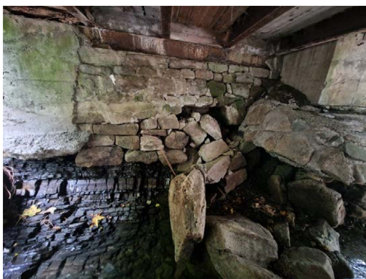
Obr. 10: Podemleté opěry po opadnutí vody
