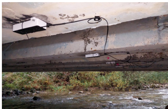
Obr. 9: Nainštalované snímače na spodnej príрубе segmentového mosta.
