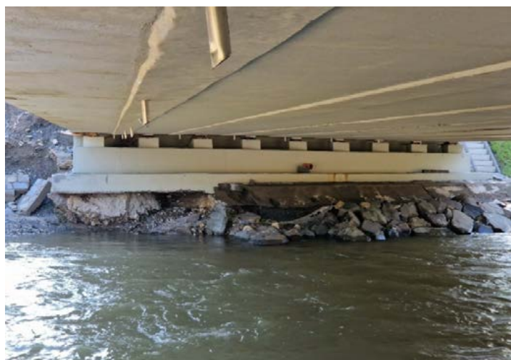
Obr. 4: Pohled na částečně podemletou opěru
