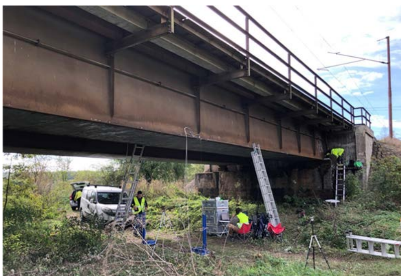
Obr. 3: Instalace měření na mostě v Otradovicích
