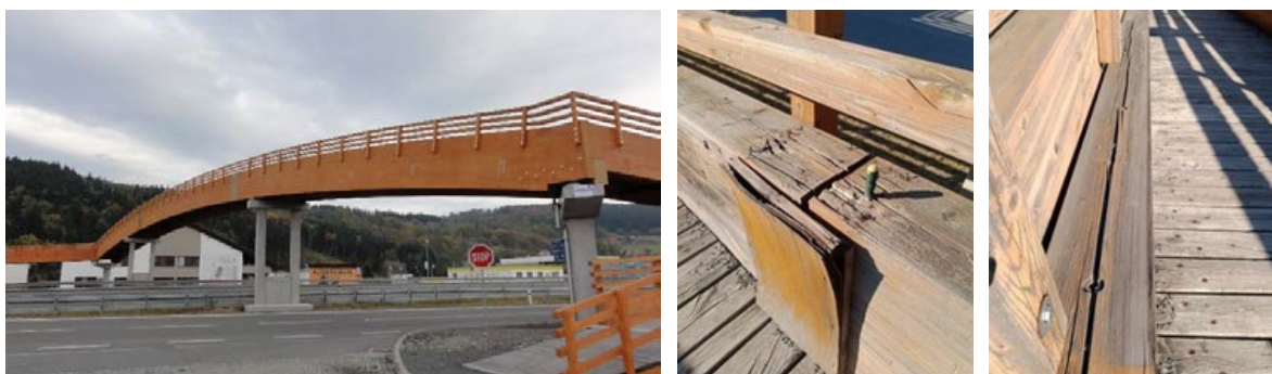
Obr. 5: Dřevěná lávka bez konstrukční ochrany poškozená atmosférickou degradací.
