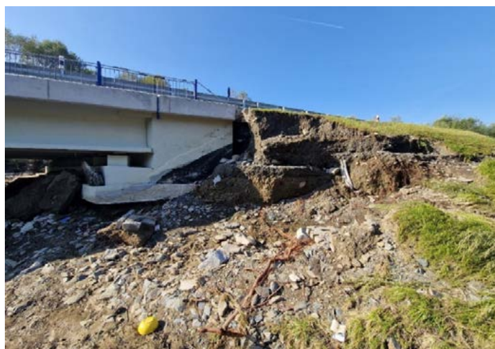
Obr. 3: Pohled na opěru a nátrž navazující komunikace
