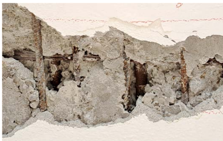
Obr. 6 Fotografia rozsiahlej kaverny na železobetónovej stropnej konštrukcii
