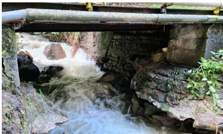
Obr. 9: Podemleté opěry ještě při zvýšeném průtoku
