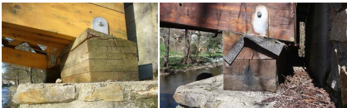
Obr. 2: Úložný práh dřevěné lávky z lepeného lamelového dřeva z roku 2023 po 8 letech provozu (vlevo), úložný práh po opravě v roce 2024 (vpravo).
