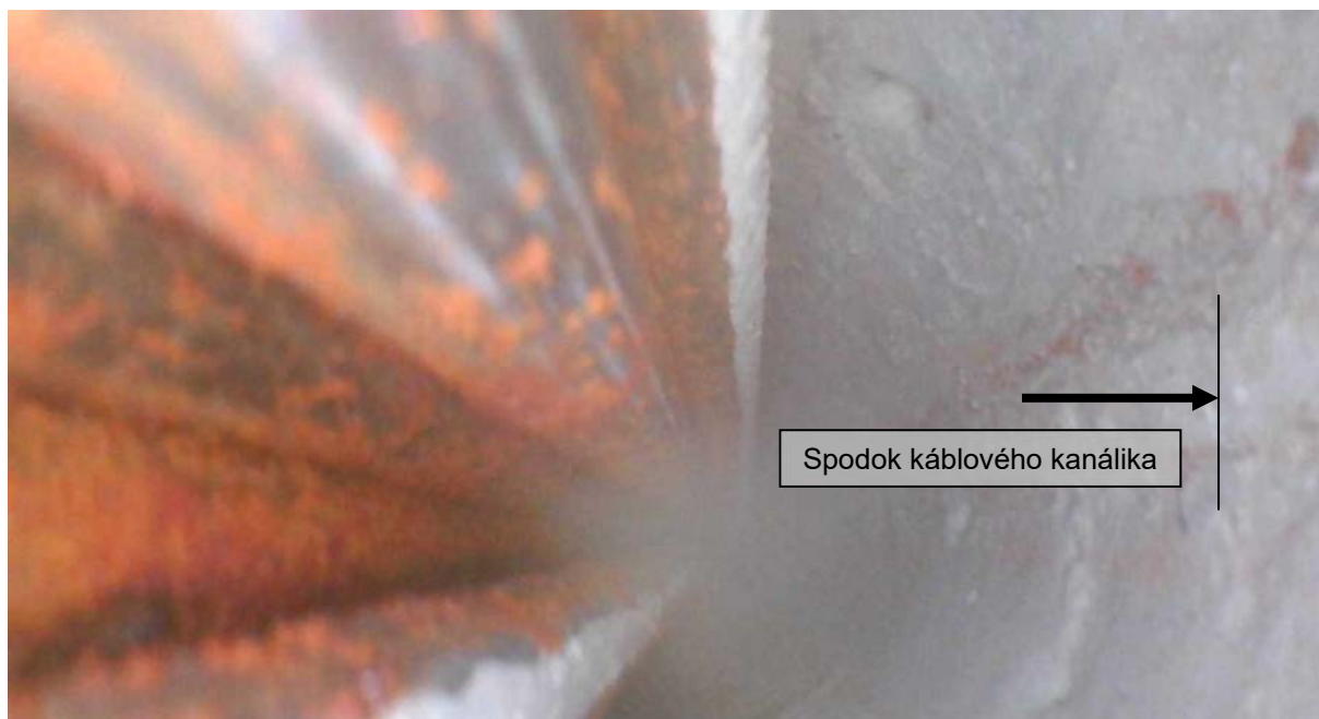
Obr. 4 Šikmá poloha zdvíhaného káblového kanálika – kábel bol injektovaný riedkou cementovou maltou pravdepodobne liatou do káblového kanálika bez riadneho obalenia drôtov.
