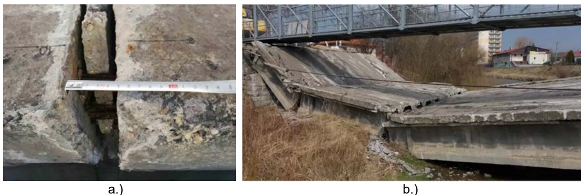
Obr. 1: Most v Trstenej – a.) otvorenie škáry pred kolapsom; b.) kolaps.
