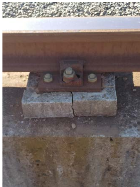
Obr. 8. Trhliny a odpadnutie častí v pôvodných betónových soklíkoch – severná strana
