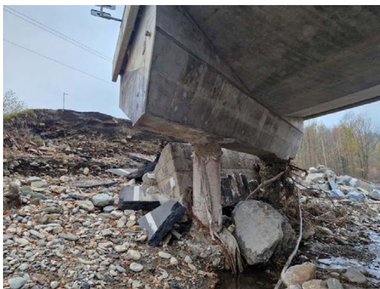
Obr. 6: Obnažené piloty, chybějící přechodová oblast
