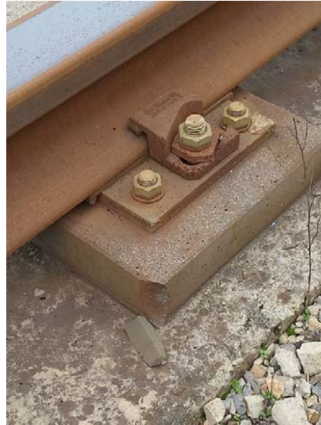
Obr. 6. Odlúpenie rohu zrekonštruovaného soklíka – južná strana
